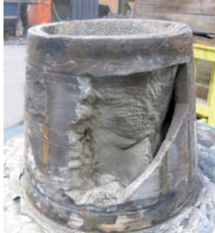
Tukkeutunut Nash-kartio, paikan päällä tehdyn tutkimuksen mukaan tehon häviö oli 85 %.
